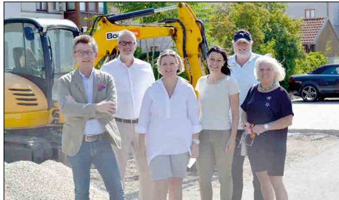
Baustadtrat Hubert Holzer und Bauamtsleiter Wolfgang Schenk sahen sich mit GR Karin Schuster-Zwischenberger, StR Elisabeth Kerschbaum, GR Johann Pirgmayr und GR Traude Wobornik an, wie weit die Arbeiten in der Vera-Frankl-Straße schon fortgeschritten sind.
